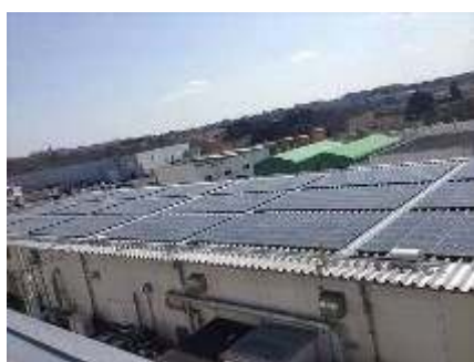
工場屋根に設置したメガソーラー
